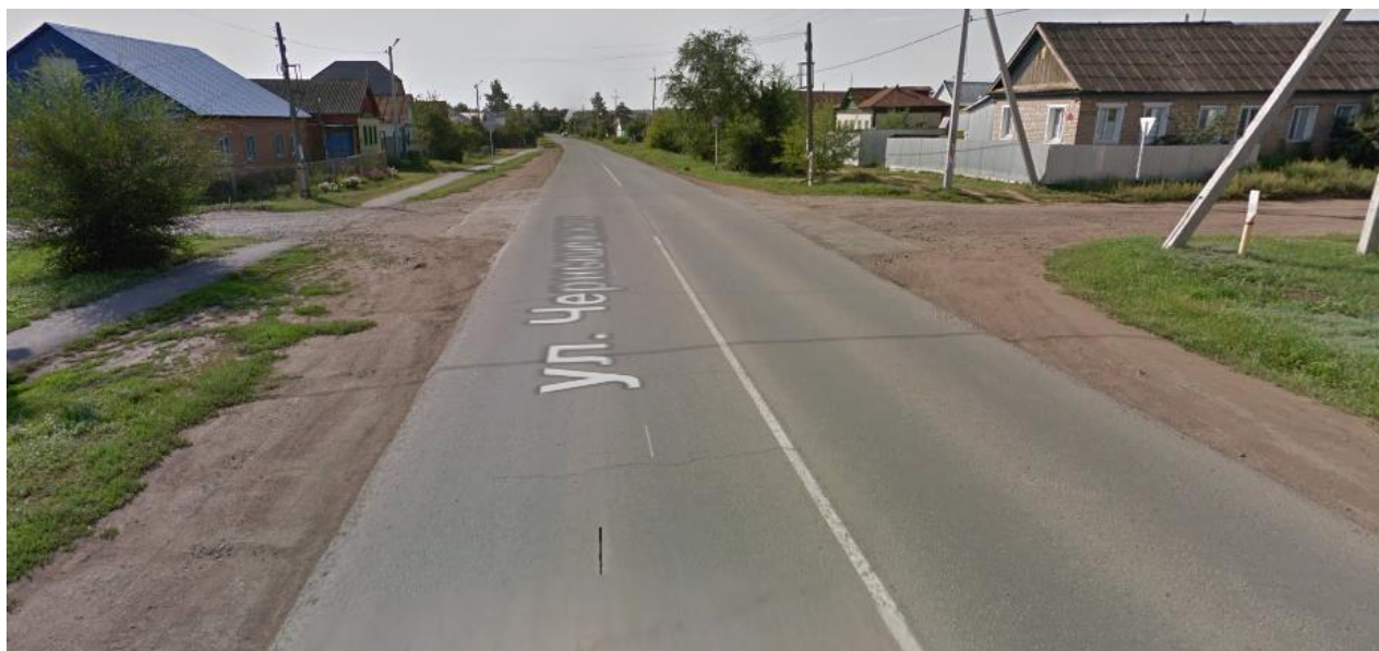
Рисунок 3 – Состояние дорожного покрытия ул. Чернышевского.
