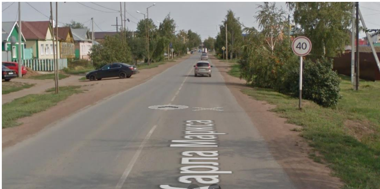
Рисунок 1. – Состояние дорожного покрытия ул. Карла Маркса.
