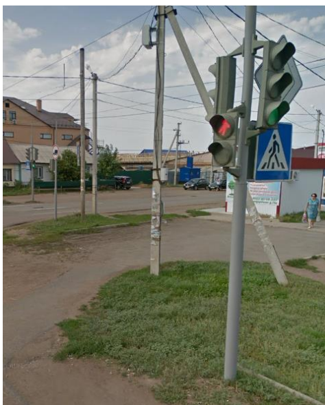
Рисунок 4 – Пример эксплуатационного состояния светофора, расположенного в г. Сорочинска, по ул. Фрунзе
