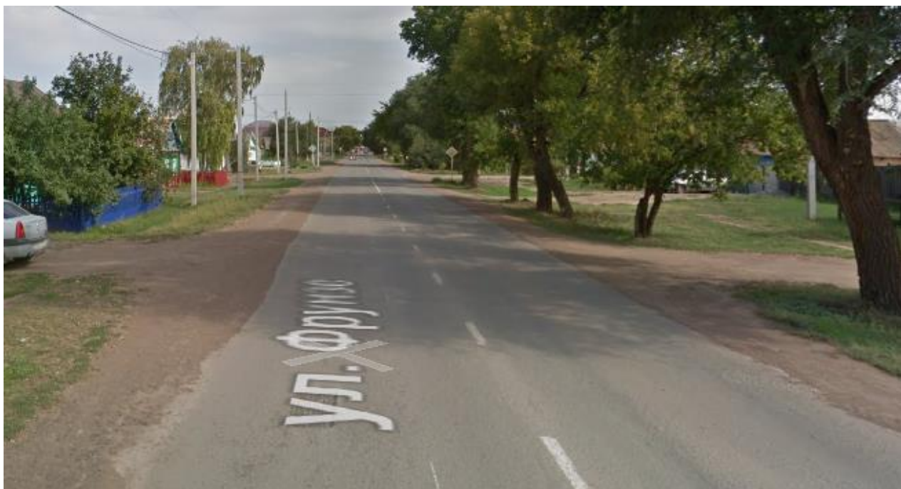
Рисунок 2 – Состояние дорожного покрытия ул. Фрунзе.
